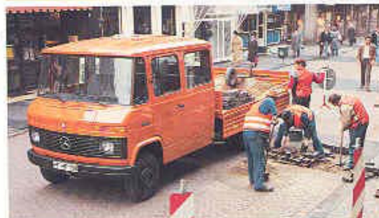
Véhicule à plateau avec double cabine pour le transport du matériel et du personnel.
